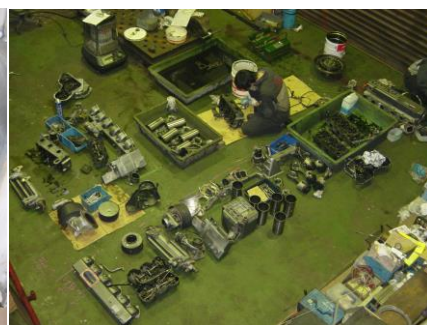
11号主機分解状況
