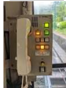
無線通信設備
